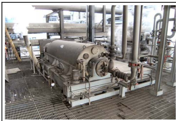
Decantadora en operación
